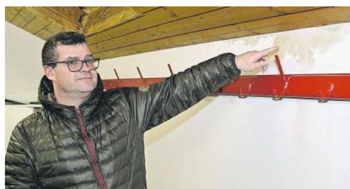
Abplatzungen des Verputzes und Verfärbungen des Mauerwerkes deuten gemäss Aldo Frei vom Sportplatzkonsortium darauf hin, dass Wasser in das Mauerwerk eindringt.
