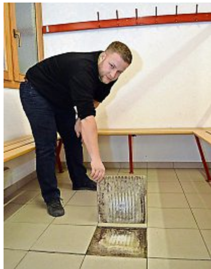
Ralf Schneider, Mitglied der Subkommission, zeigt, dass ein grosser Teil der Bodenplatten lose ist. Nebst diesen sichtbaren Schäden werden noch viel gravierendere, verdeckte Schäden und Mängel vermutet. z.V.g.
