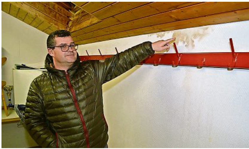
Abplatzungen des Verputzes und Verfärbungen des Mauerwerkes deuten gemäss Aldo Frei vom Sportplatzkonsortium darauf hin, dass Wasser in das Mauerwerk eindringt.
